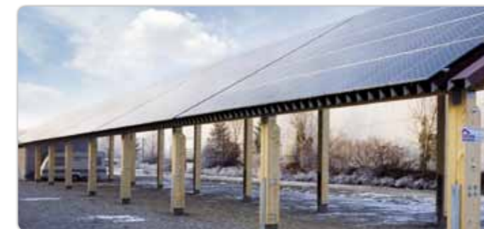
Überdachungen mit Pultdach schaffen nicht nur flexible Außenlagerplätze sondern auch Platz für besonders große Photovoltaikanlagen.
